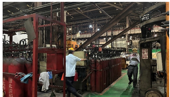
操作人員手動切換第二組 CO2 噴灑
