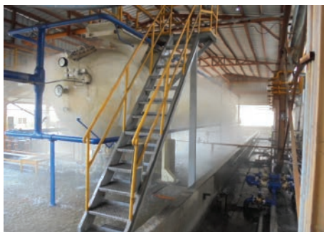
廠外氨槽管路外洩，自動灑水啟動
