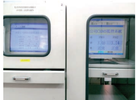
排放管道不透光率連續自動監測系統（CEMS）
