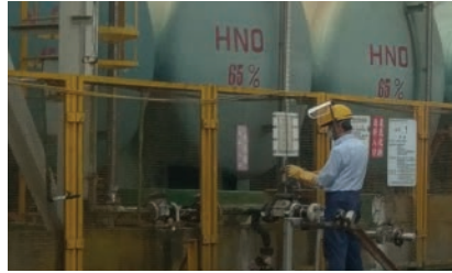
啟動儲槽噴灑系統
