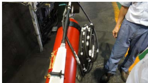
演練過程中發現100磅手動滅火器皮管有破裂現象
